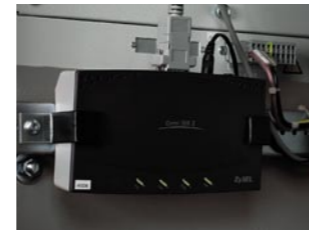
Possibilité de collecte des données et de connexion par modem pour l'entretien courant à distance de la machine.
